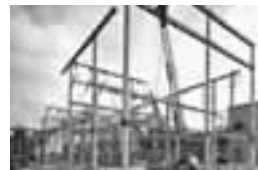
p.32, Stazione elettrica di trasformazione
