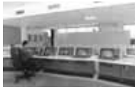
p.116, 2002, centrale operativa elettrica, sala comandi
