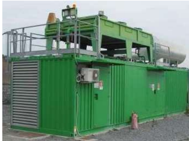
Figura 10 – Impianto biogas discarica
