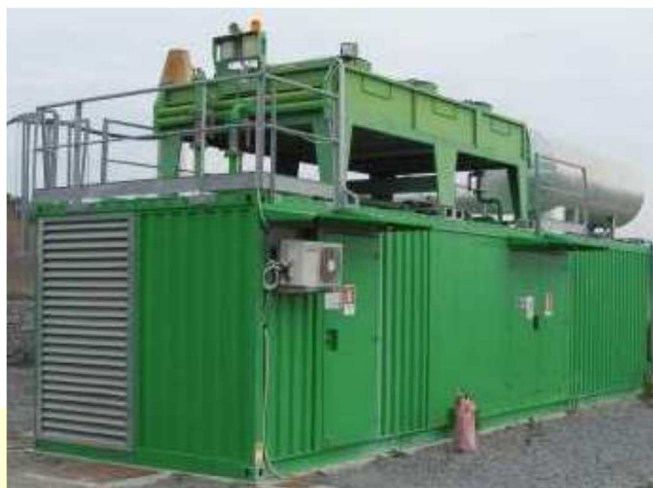
FIGURA 6 – IMPIANTO BIOGAS DISCARICA
